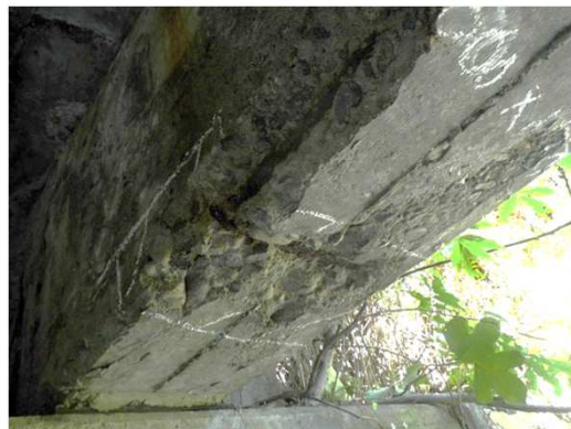
桁の断面欠損
