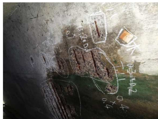
床版の鉄筋露出
