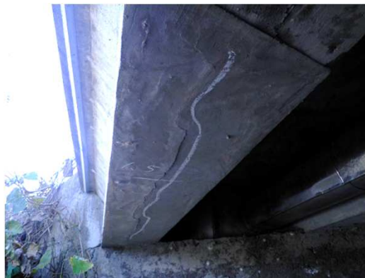
主桁のひび割れ
