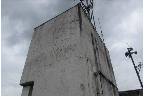
塔屋仕上げ塗装の劣化
