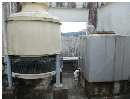
冷却塔・膨張タンクの老朽化
