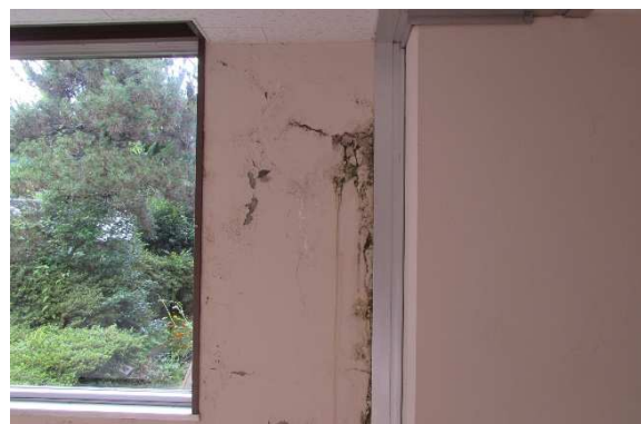
廊下雨漏り跡
