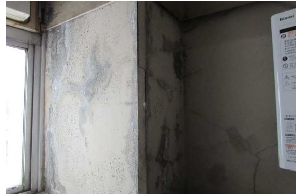
3階湯沸室クラック
