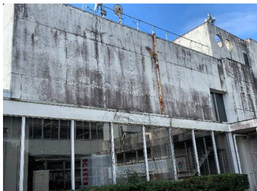
外壁のクラック
