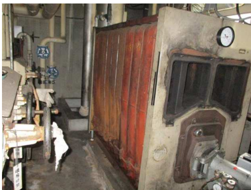
ボイラーの老朽化
