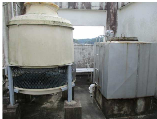
冷却塔・膨張タンクの老朽化
