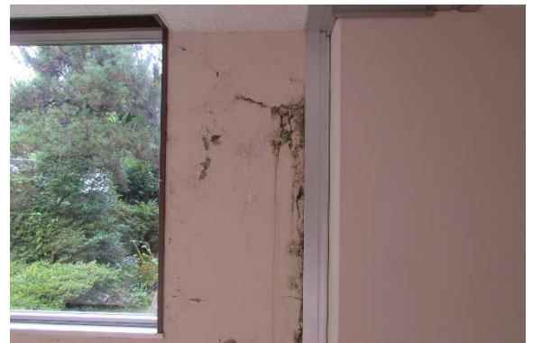
廊下雨漏り跡
