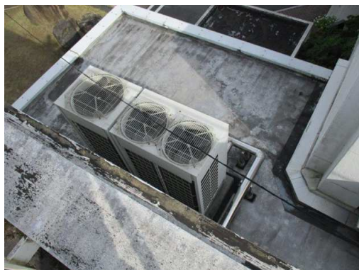
マルチエアコン室外機
