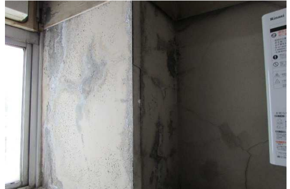
3階湯沸室クラック
