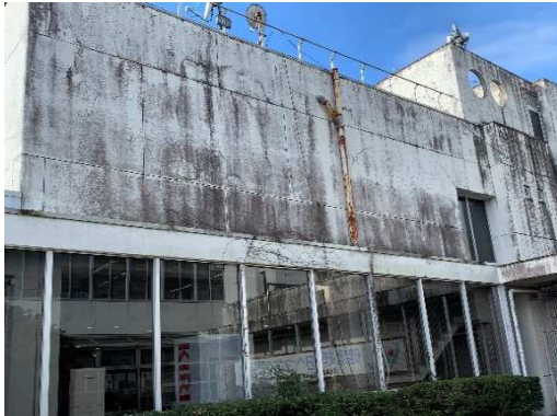
外壁のクラック
